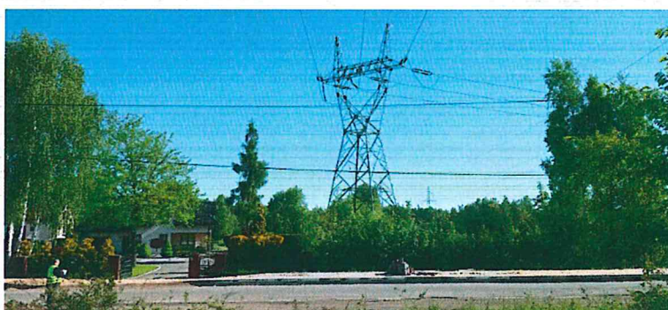
Droga wojewódzka w prześle 2 – 3 linii 220 kV
