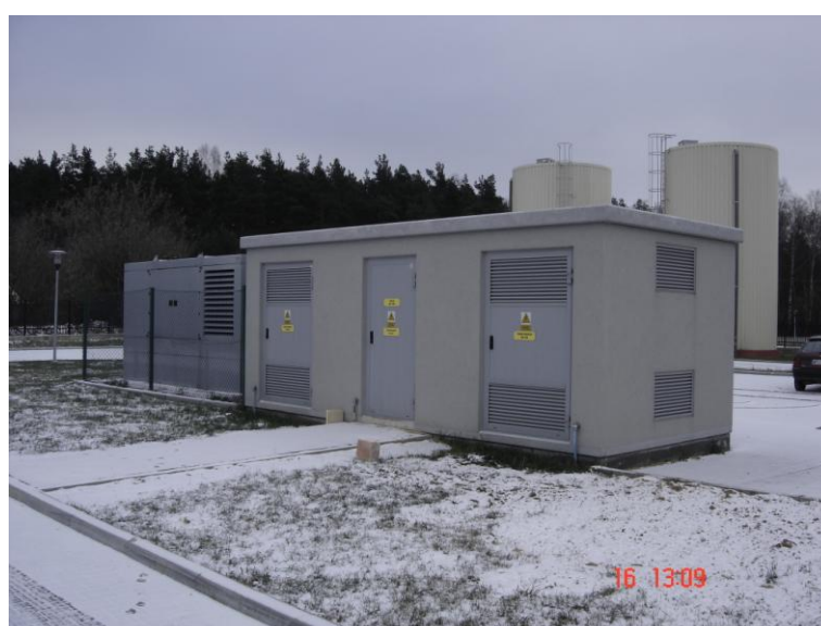
Stacja transformatorowa i kontenerowy agregat prądotwórczy
